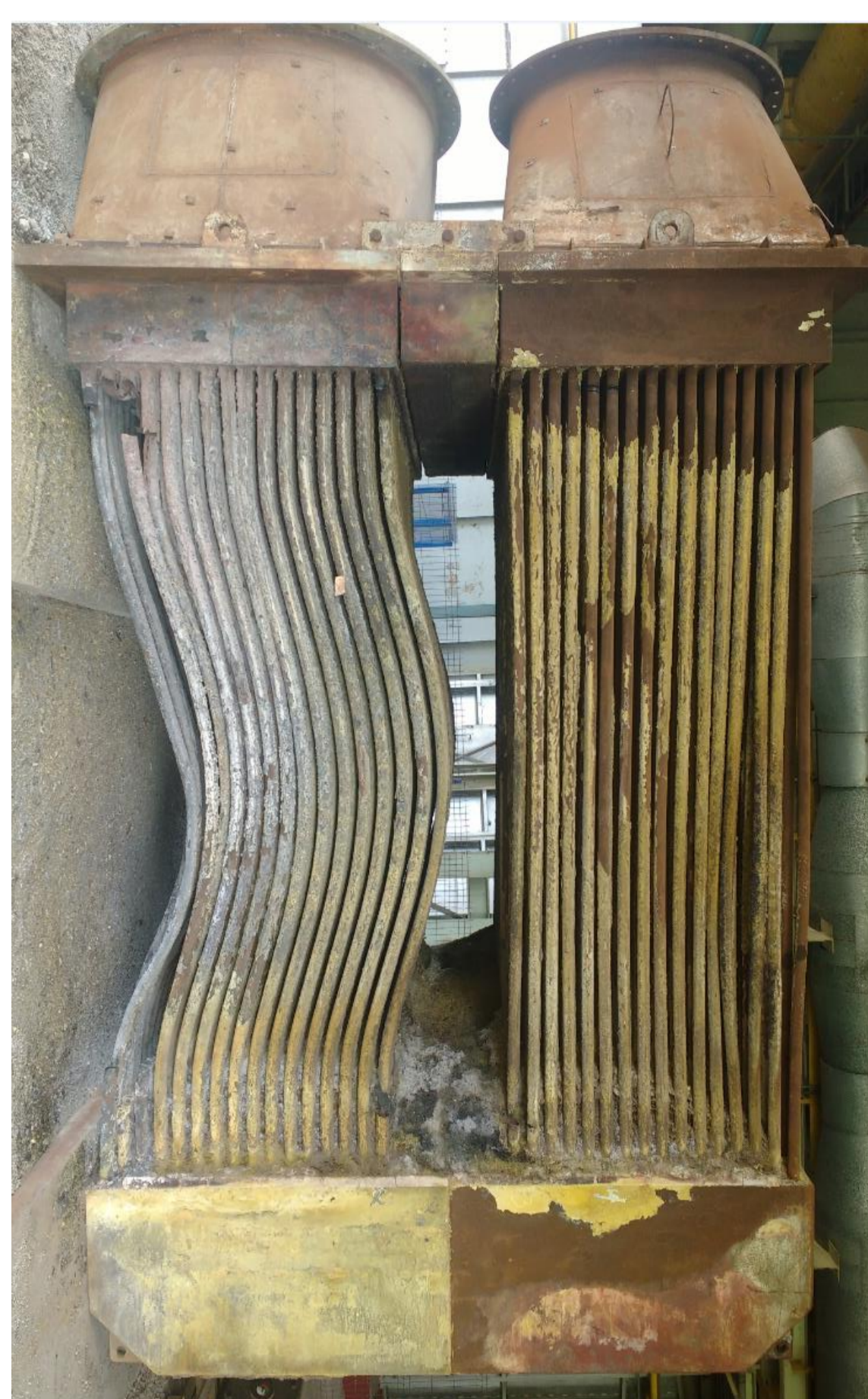
Recuperador de calor após 12 anos de operação
