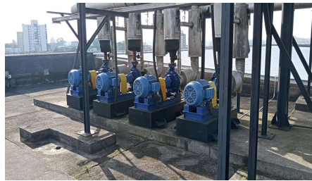
Figura 03 – Bombas de resfriamento no prédio K
